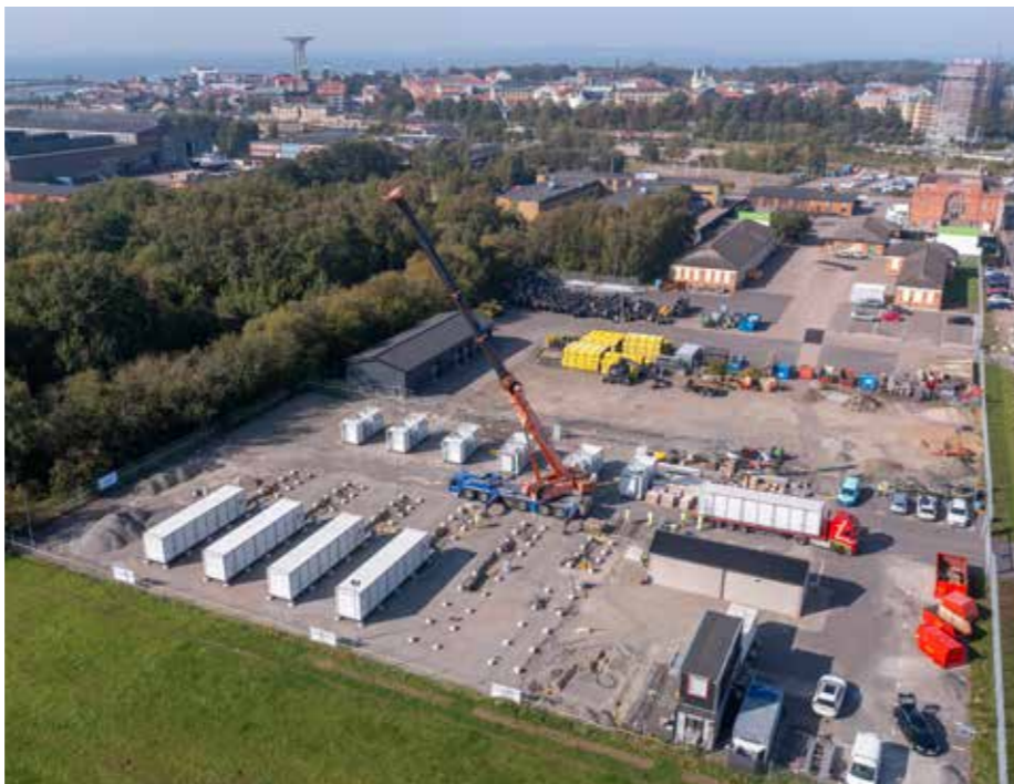
Axpos batterilagret växte fram under hösten 2023 i anslutning till Landskrona Energis lokaler på Gasverksgatan i Landskrona.
