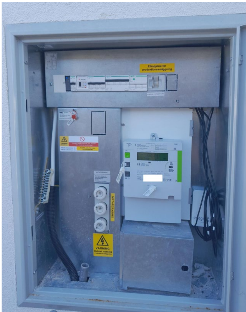
Exempel på ett korrekt märkt fasadmätarskåp
