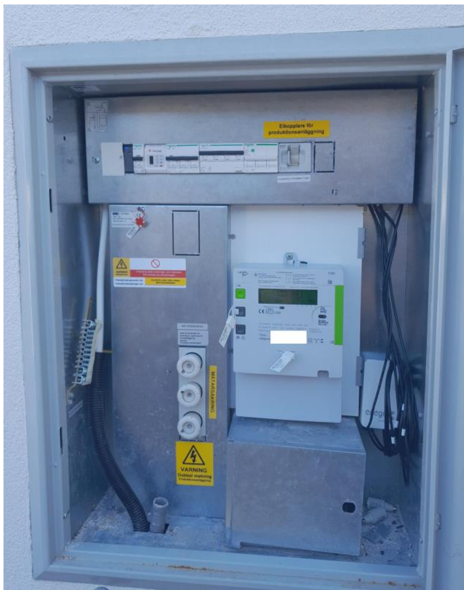
Exempel på ett korrekt märkt fasadmätarskåp
